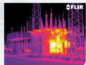
Transformador com sobreaquecimento.
