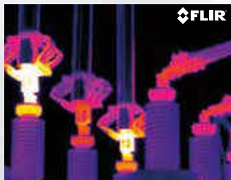
Inspeção térmica de uma estação de alta tensão.
