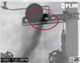
Vazamento de gás claramente visível pela imagem térmica.
