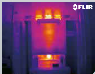
Sobrecarga em fusível.
